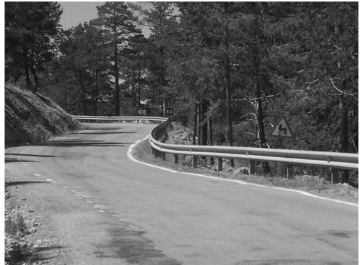
Imágen de carretera en mal estado
